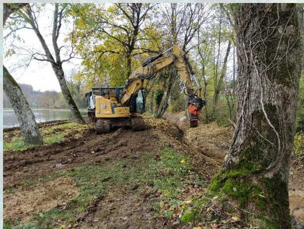
Terrassement du lit emboîté de la Sainte-Eugénie à l'amont de la digue de l'étang
